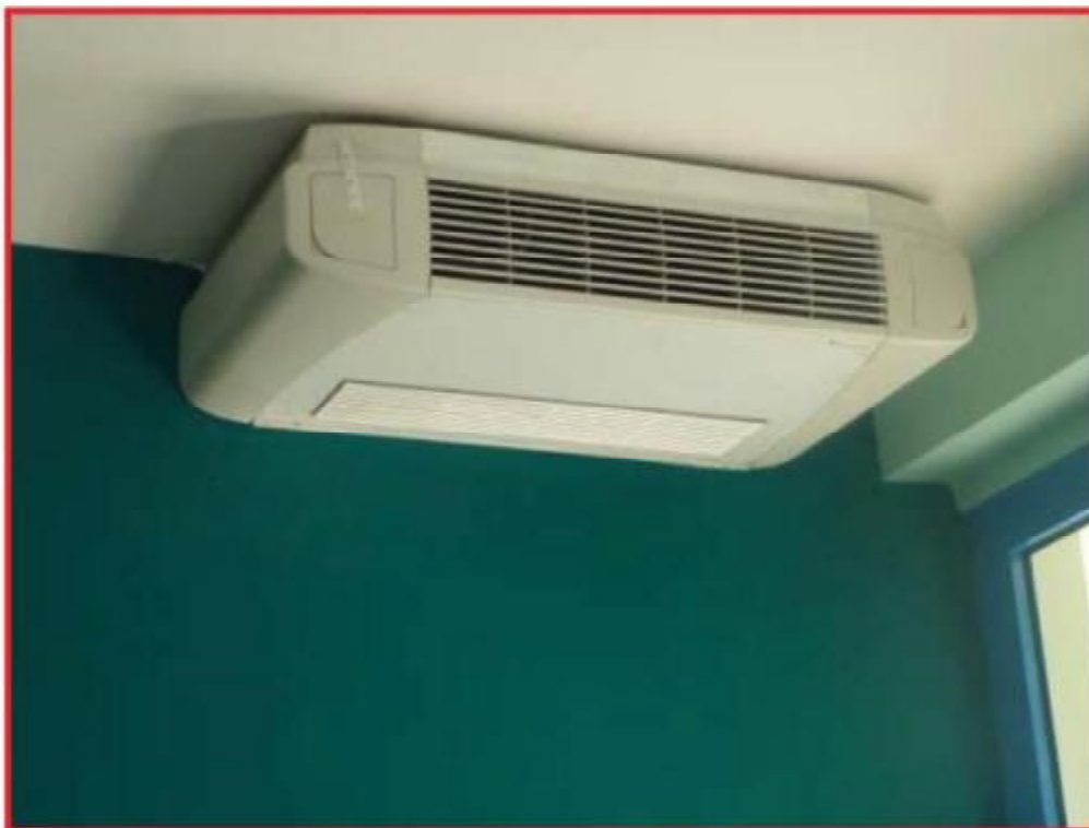
FOTO 11 - Particolare fan coil
