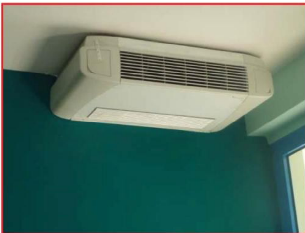
FOTO 11 - Particolare fan coil
